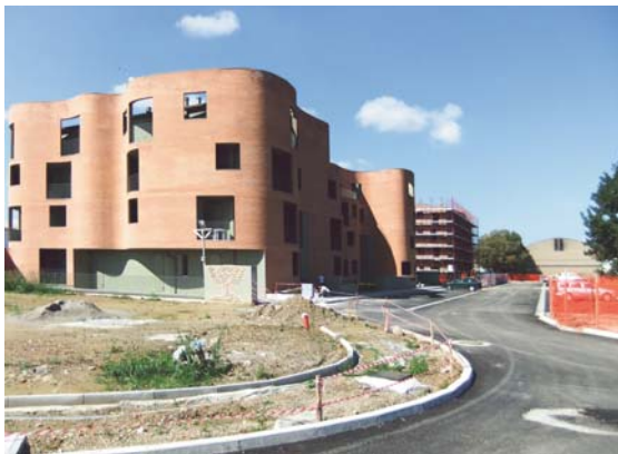
Area residenziale "San Rocco": i nuovi condomini in fase di ultimazione limitrofi a via Ravegnana (Archivio Comune di Faenza - Settore Territorio).
